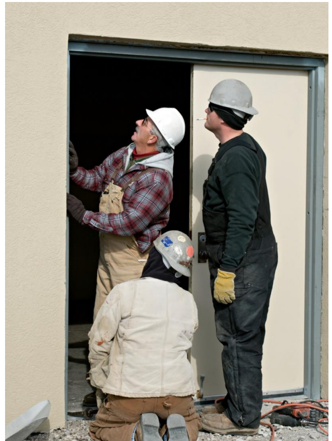
Figura 1.1. Trabalhadores da Construção Civil enfrentam muitos perigos. O Setor tem uma alta taxa de acidentes e até de mortes. O homem da direita está tornando as coisas ainda piores por fumar no trabalho, o que é contra as regras. O tabagismo representa um grave perigo de incêndio no trabalho e contribui para prejudicar ainda mais a sua saúde. (Fotografia © Dreamstime. )
