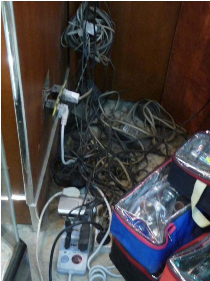
Figura 2.3. Muitos plugues elétricos em muito poucas tomadas. Estes cabos elétricos e tomadas, em uma loja no Egito, estão perigosamente sobrecarregados. A tomada de parede tem poucas plugues. Esta situação é susceptível de provocar um incêndio.
